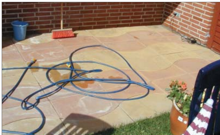
Almindelige kalkudfældninger på farvede sten. Højre del af belægningen er netop afsyret, og kalkudfældningerne er væk.
